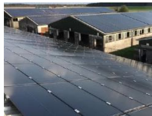
Deutschland Dachanlage in Betrieb 580 kWp
